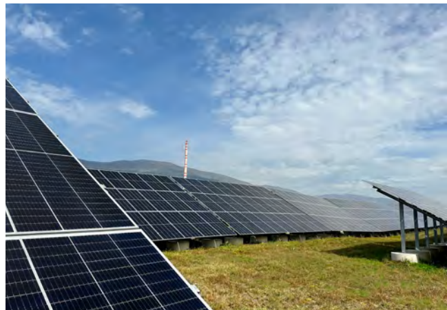
Der Solarpark von Aurubis Bulgaria: landesweit einzigartig.
